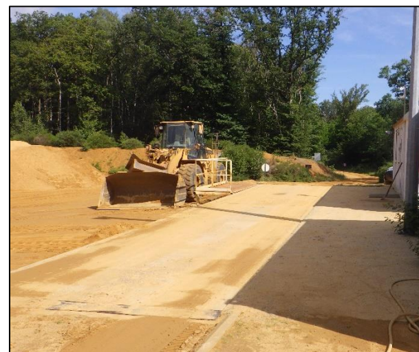
Photo 9 : Pont-bascule situé à l'entrée de la carrière
